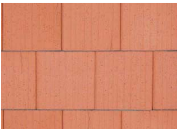
Bild 12: Ziegelmauerwerk mit Trocknungs- oder Brennrissen
