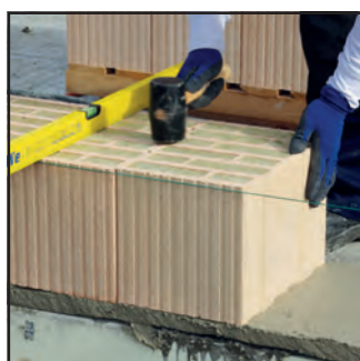
Die erste Ziegellage wird auf das exakt abgezogene Mörtelband gesetzt. Mit Wasserwaage und Gummihammer werden die Ziegel feinjustiert.
