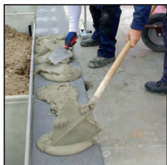
Unebenheiten der Bodenplatte werden mit einer Mörtelausgleichsschicht (= Kimmschicht) korrigiert. Diese sollte im Regelfall 30 mm nicht überschreiten.
